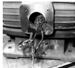
Figura 4 Motor con falla producto de un problema en la conexión (Fuente: EASA)
