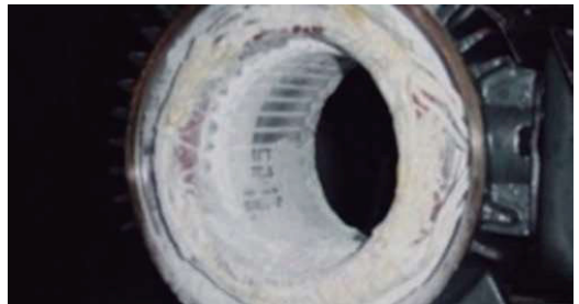
Figura 6. Exceso de contaminación interna
