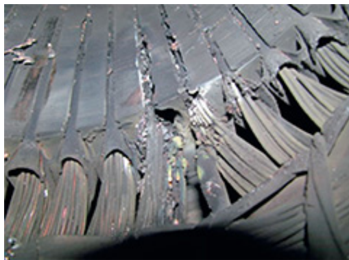
Figura 1. Núcleo con daño severo.
